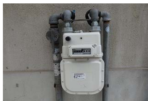
ガスメーター
