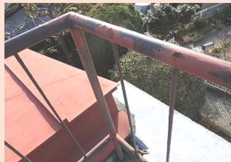
例) フェンスの腐食
