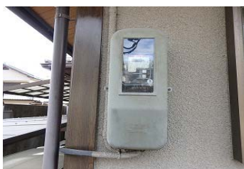
電気メーター
