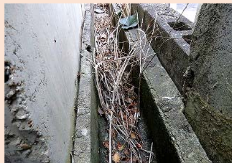
例) 側溝の詰り
