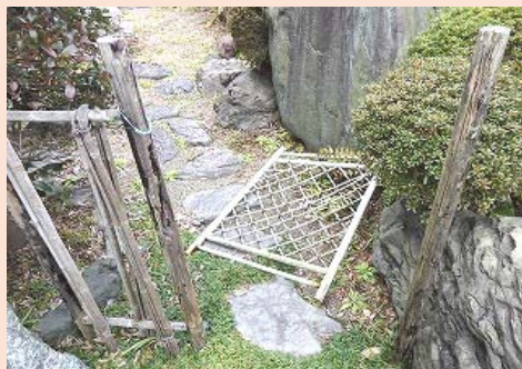
例) 倒れたフェンス（作業前）
