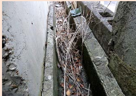
例) 側溝の詰り
