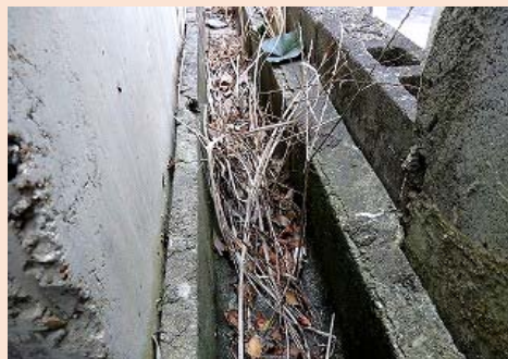
例) 側溝の詰り
