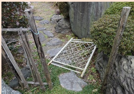
例) 倒れたフェンス（作業前）
