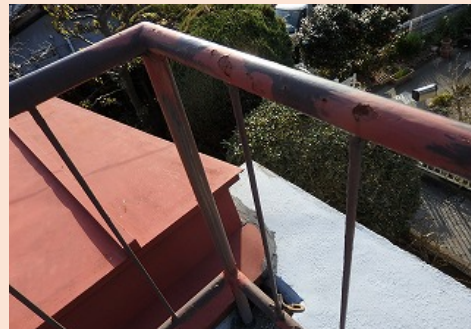
例) フェンスの腐食
