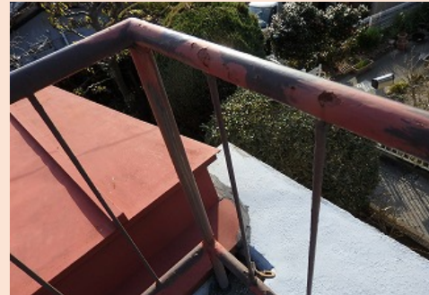
例) フェンスの腐食
