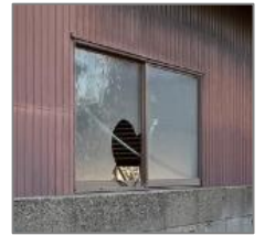
窓が割れた管理不全空家
