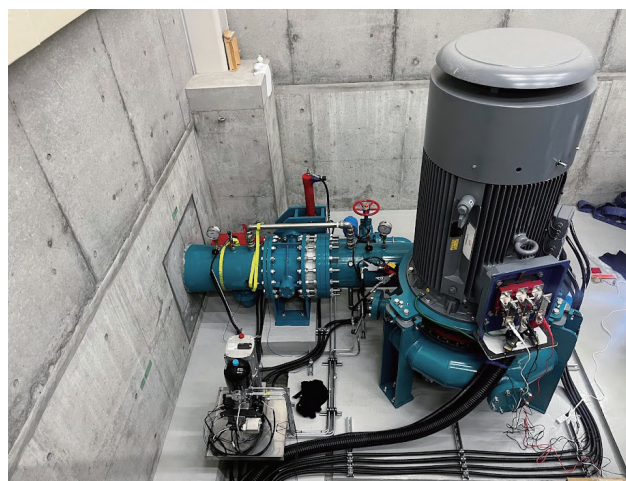
富山県朝日町笹川地区小水力発電所
