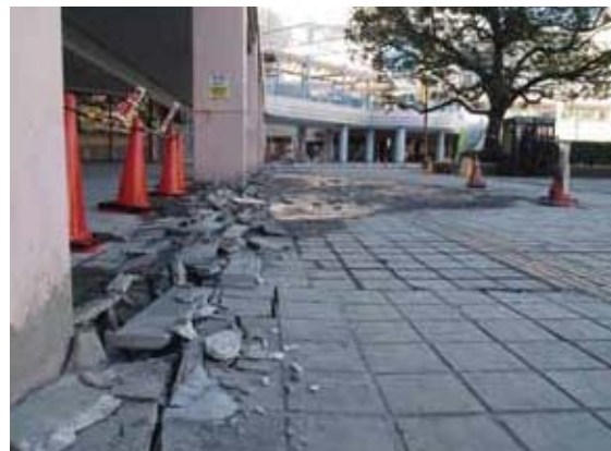
浦安市では液状化の被害が多くのエリアで発生。今泉氏自身も被災者となった〈写真提供：(株)明和地所〉
